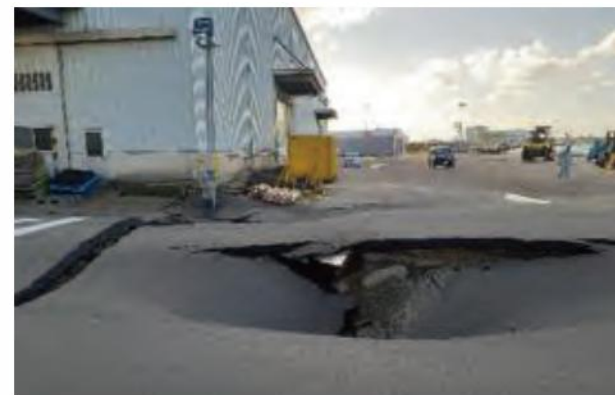
写真3 御供田ふ頭の被害の様子
