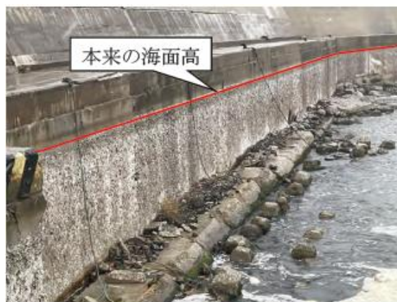
写真1 海底隆起が発生した鹿磯漁港
