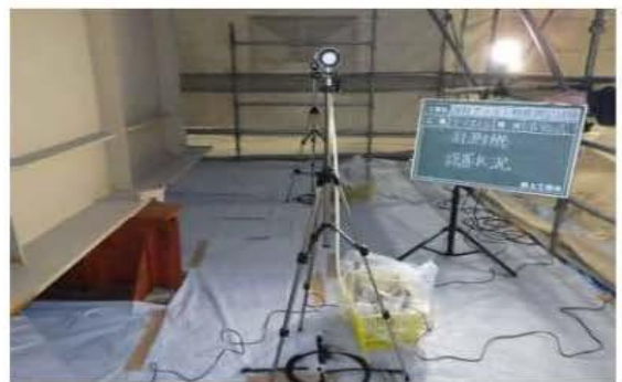
写真 1-2 計測器(ケージ内)
