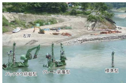
写真-12 落橋回収状況
