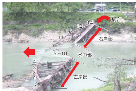
写真-11 落橋した西部橋
