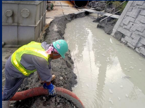
建設現場から発生した無機汚泥
