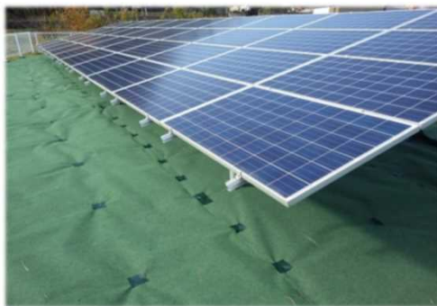
太陽光発電所
