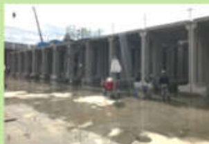
地下式雨水貯留槽
