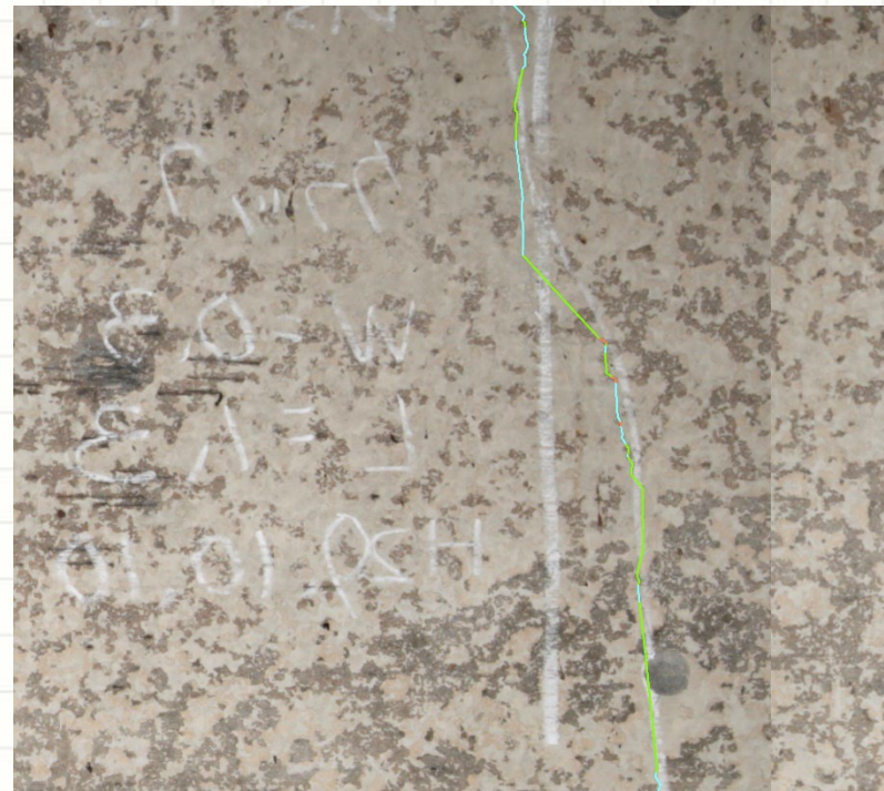
ひび割れ抽出画像
