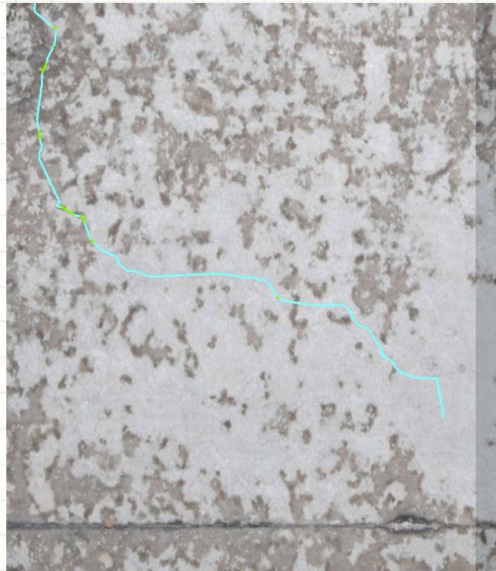
ひび割れ抽出画像
