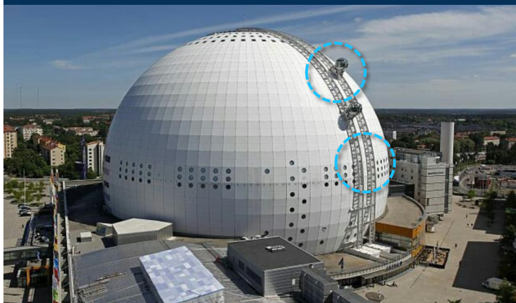
ビル外壁のゴンドラ用のレール（スウェーデン）
