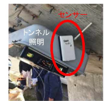
トンネル内附属物の異常監視センサ
