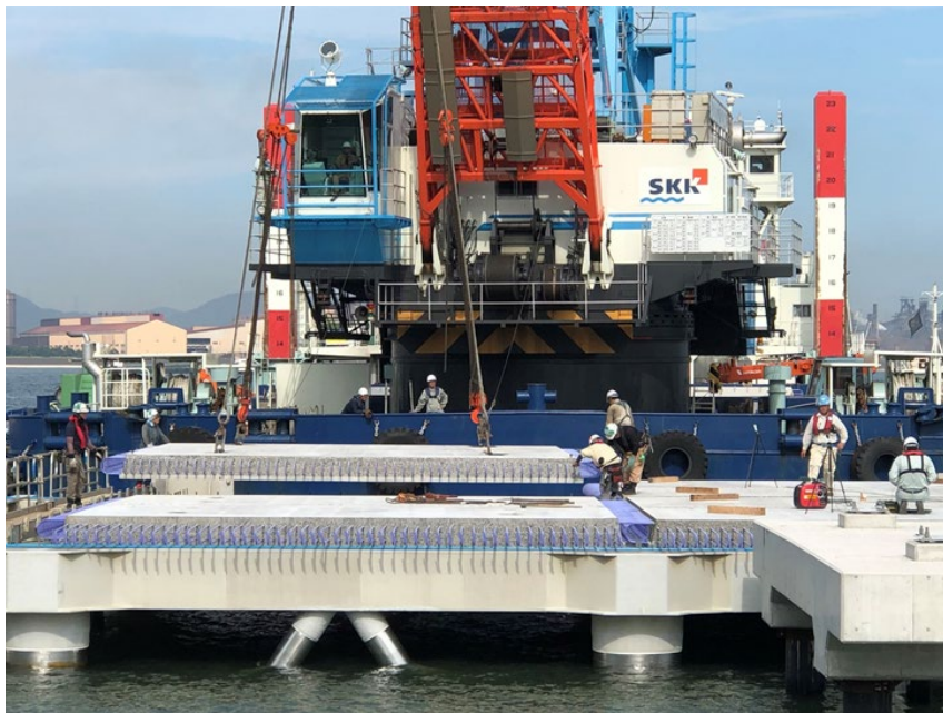
ジャケット式棧橋床版 中国地方整備局宇野港湾事務所
