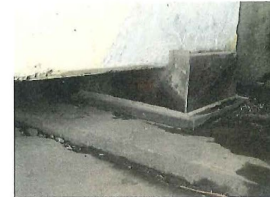
図-4.1.13 点検困難なカバー(PC橋)
