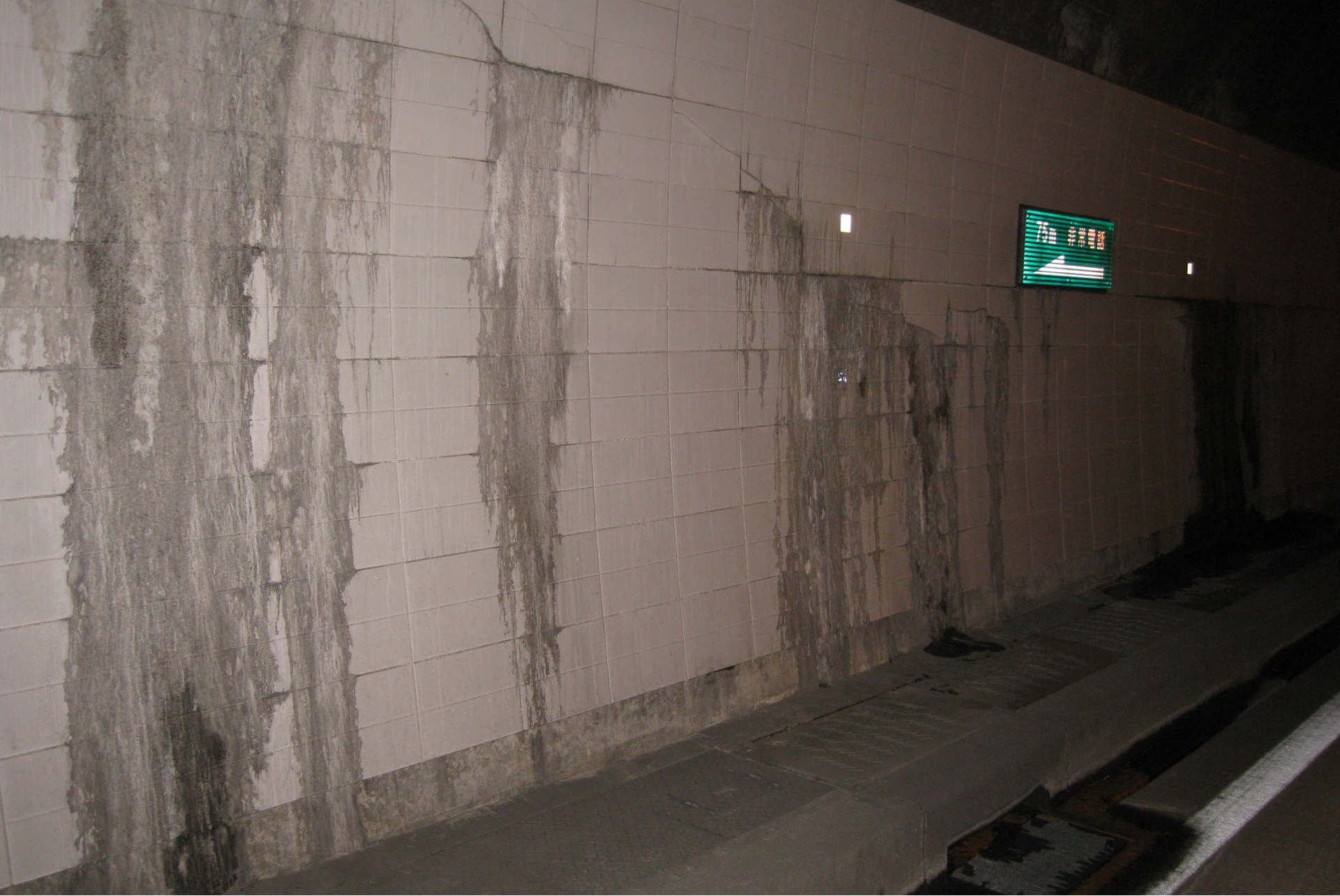
側壁部に連続クラックが入って漏水
