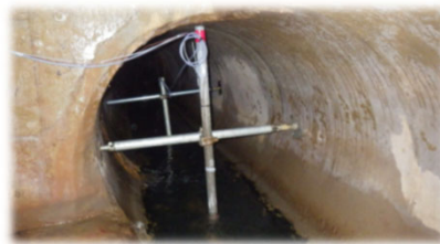
水温・水深測定用センサ取付例
