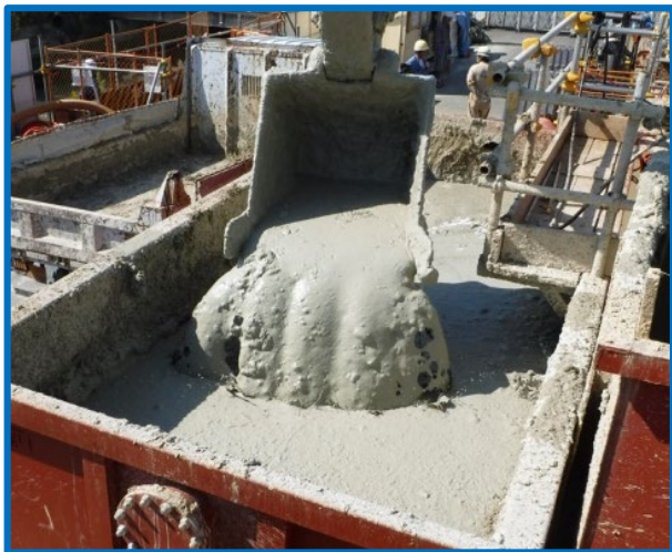
① 高含水泥土発生
