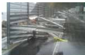
防波フェンスの被災例
