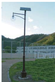
ソーラー LED照明灯
