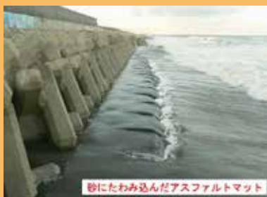
砂にたわみ込んだアスファルトマット
